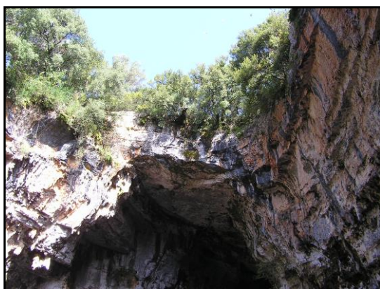
Εικόνα 2.23: Αρνητική παράμετρος για την εκδήλωση καταπτώσεων είναι το πάχος της οροφής σε ορισμένα σημεία του σπηλαίου προς τη ΒΔ πλευρά του. Το πάχος είναι μόλις μερικά μέτρα (4-5 m) και με δεδομένο το μεγάλο πλάτος της οροφής εγκυμονεί κίνδυνο κατάπτωσής της.
