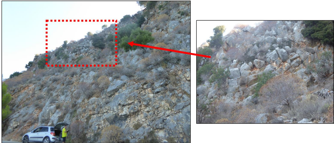
Εικόνα 11. Απεικόνιση τμήματος του πρανούς, όπου διακρίνονται χαλαρωμένα, επικρεμάμενα βραχοτεμάχια, επιρρεπή προς αποκολλήσεις.
