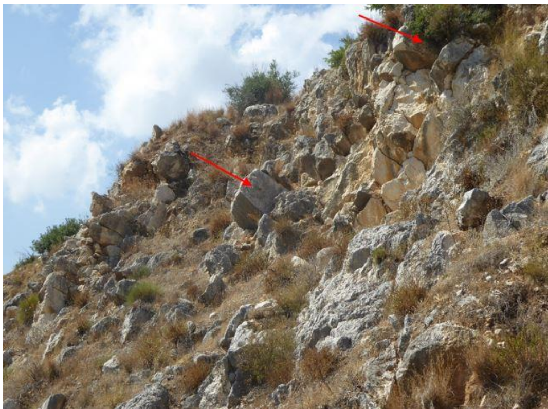
Εικόνα 16. Κοντινές απόψεις του εξεταζόμενου πρανούς με επισήμανση κάποιων εκ των επισφαλών επικρεμάμενων βραχοτεμαχών
